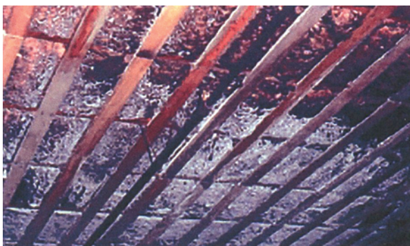
Plafond d'entrepôt contaminé à cause d'une accumulation de poussière et de condensation
